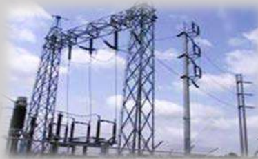
ระบบไฟฟ้า
